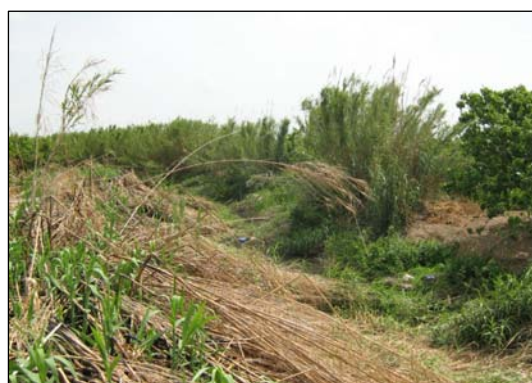
Foto 9: Orillas y cauce invadidos por caña común
